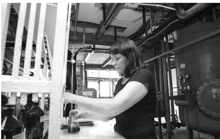
▲ В котельной идет проверка воды
