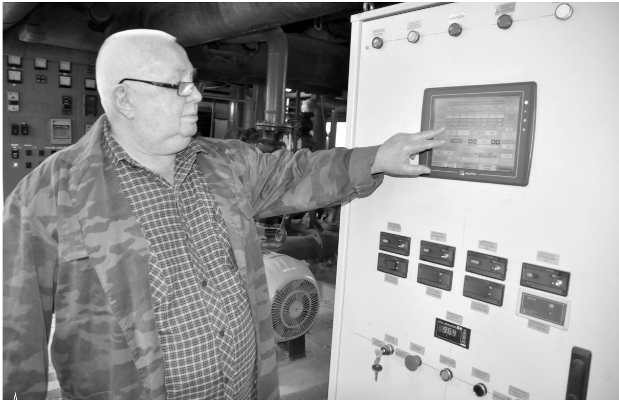
Оператор котельной Александр Белоусов
